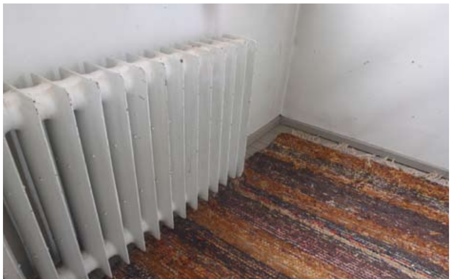
Skador som uppkommer på grund av läckande vattenelement är medlemmens ansvar enligt HD.
