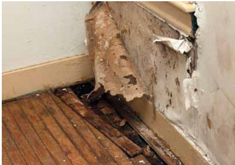
Om föreningen anses vållande till en vattenskada kan nedsättning bli aktuell.
