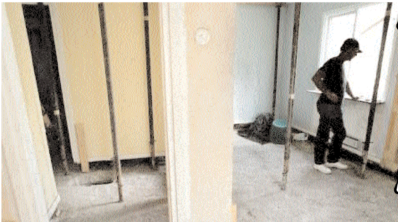
En vattenskada kräver i de flesta fall en näst intill total renovering.
